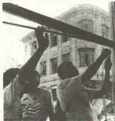
... und ersetzen zerstörte Scheiben
